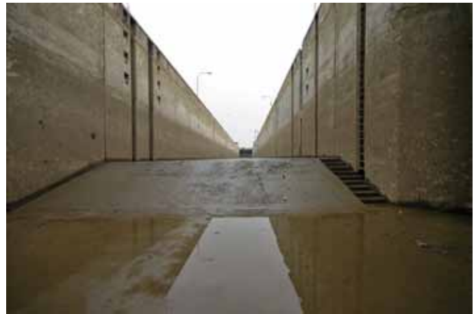
▲ Beim Blick vom Unterwassertor in die leere Schleusenammer werden die Dimensionen des Bauwerkes besonders deutlich.
