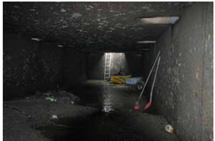
▲ Eingetriebene Sedimente im Strömungskanal unterhalb des Schleusenbeckens müssen regelmäßig beseitigt werden.
