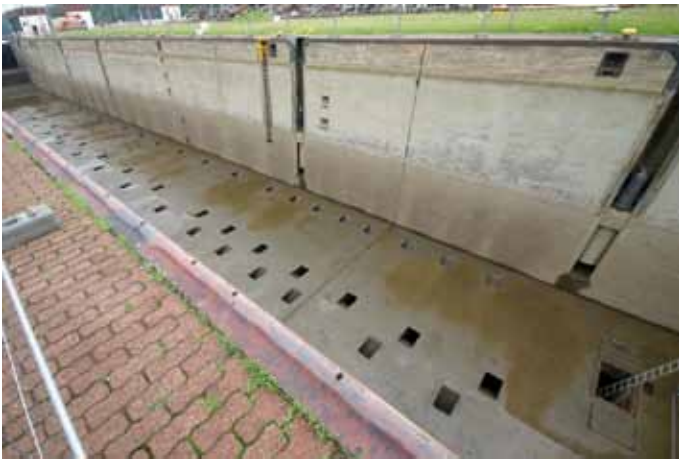
▲ Durch die Strömungsöffnungen im hinteren Kammerbecken wird ein ruhiges Wasser während des Schleusungsvorgangs erreicht.
